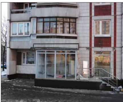
Входная группа в подвальные (цокольные или первые этажи зданий) в пределах земельного участка относящегося к общему имуществу.
